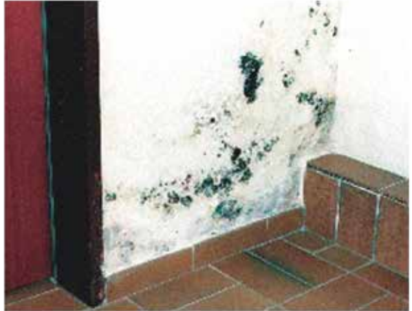
hongo formado en las paredes
